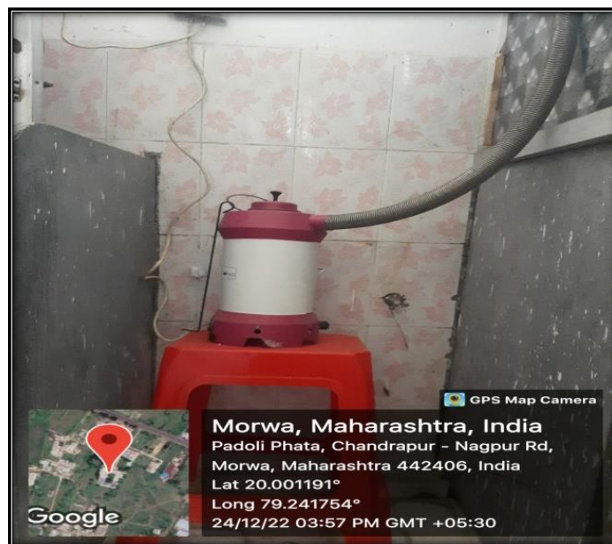
Incinerator machine (Zeropad)
